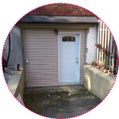
Avant travaux entrée en contre-pente
